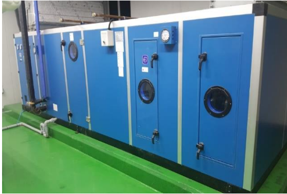
HVAC 공조시설 (1층)
